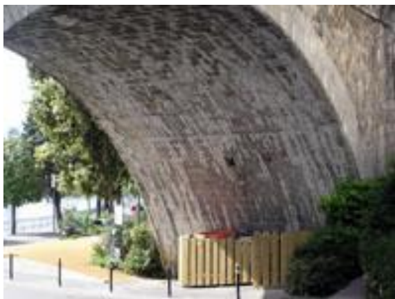
Рис. 6. Натечная кора на мосту в Монтре, Швейцария
