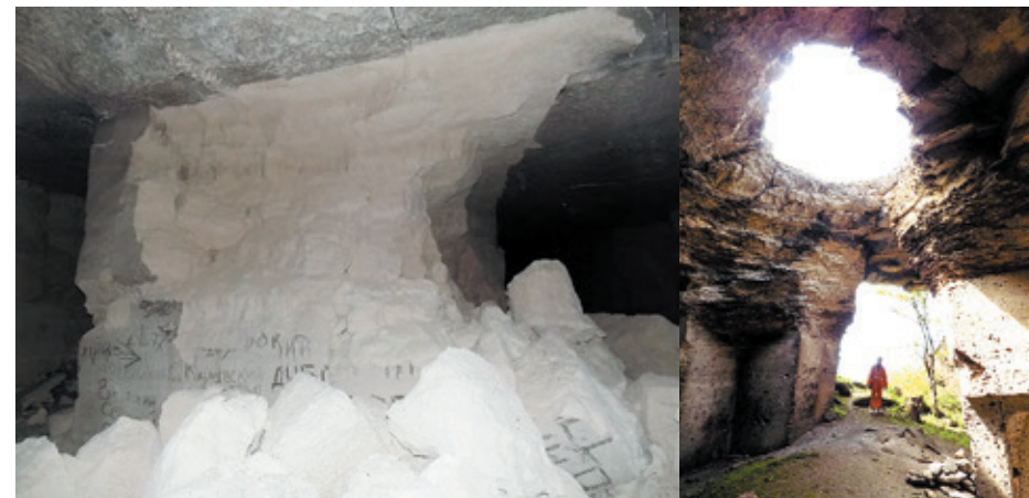
Рис. 5. Раздавленные горным давлением колонны в каменоломне Багеровской-1 и провалы в западной части каменоломни Багеровской-1
